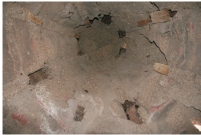
So sieht der Turmhelm von innen aus. Den Beton kann man großflächig mit bloßen Händen bis zur roten Außenschicht abkratzen.
